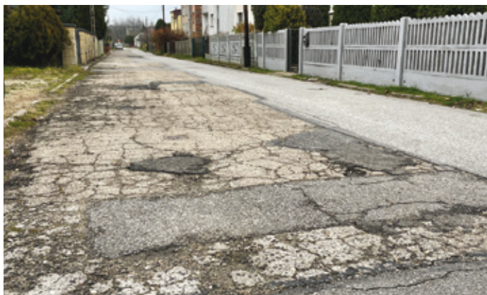
Nawierzchnia na ulicy Ogrodowej przed wykonaniem remontu.
